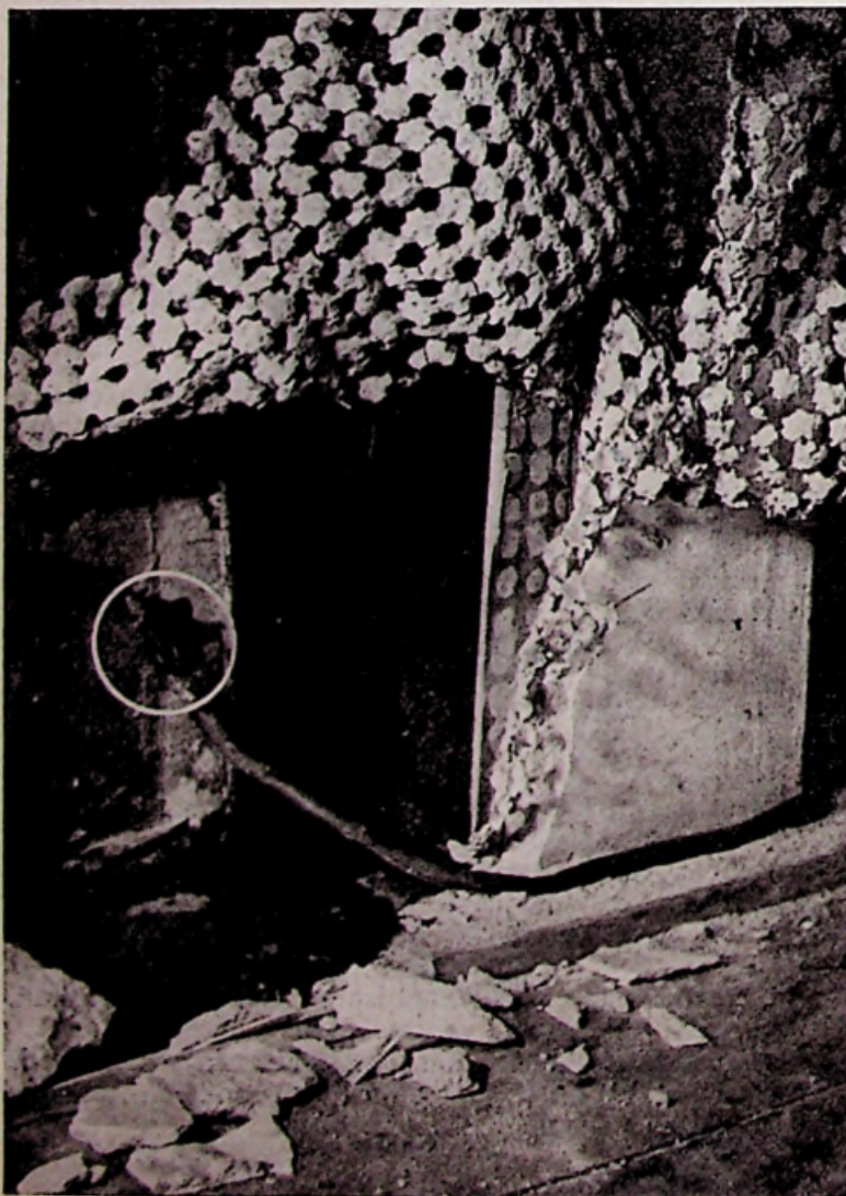
1. De opengehakte luchtkoker met beschadigde loodkabel.
